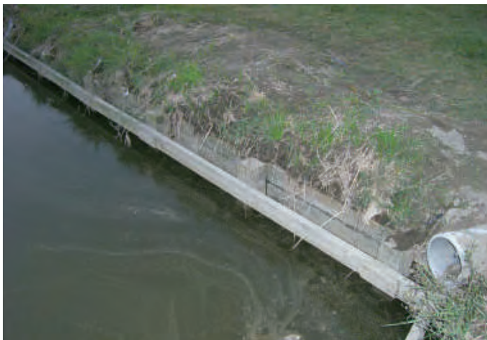
土に触れている所も腐食はなし。
