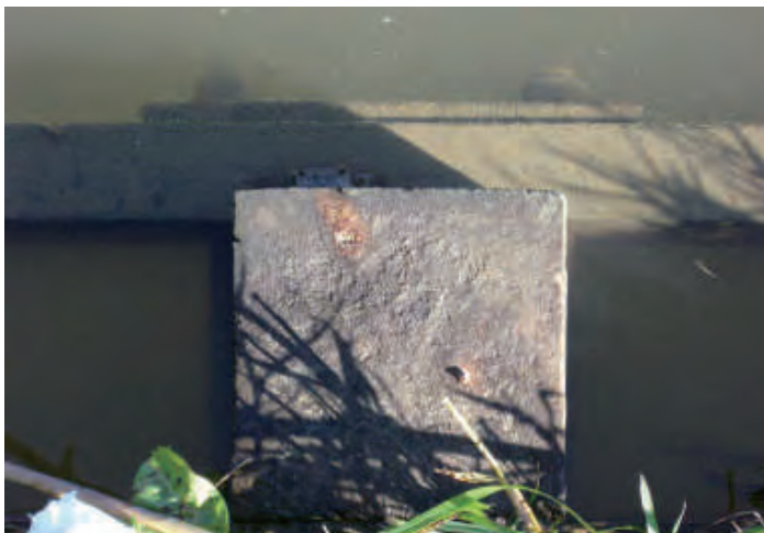
つなぎ材40×105の腐食はなし。
