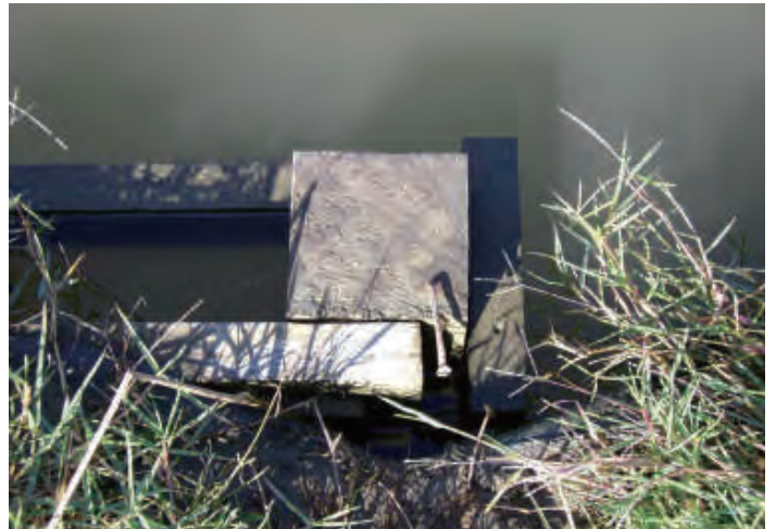
支柱：120×120頭部の腐食はなし。
