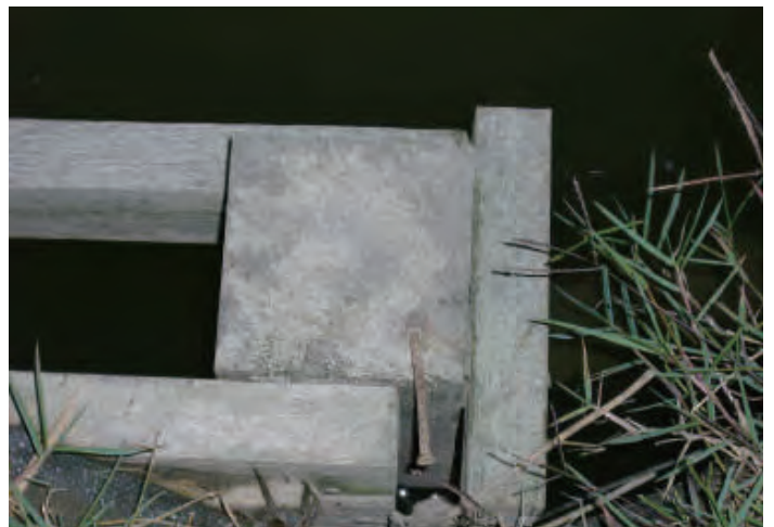
錆びた釘の周りでも腐食は全く見られない。 木材は金属錆と結露には弱く、早期に腐食が発生する。
